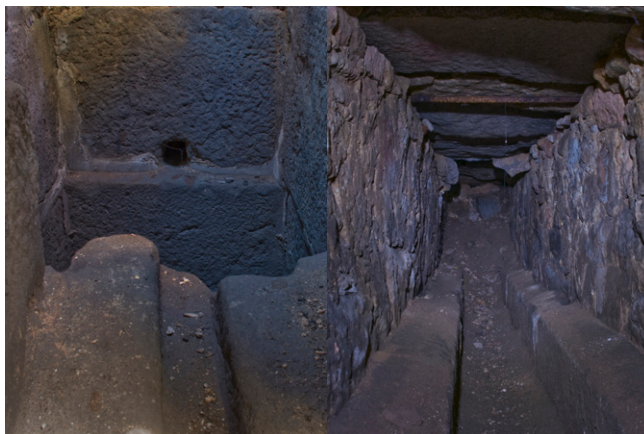
Aspecto del interior de la canalización soterrada del Acueducto a su paso por la Plaza Mayor
