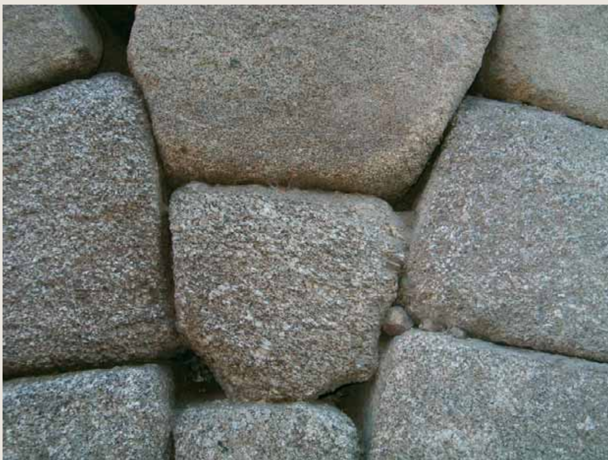
Figura 252. Fotografía de algunos sillares del Acueducto de Segovia, donde se reconocen los diferentes materiales empleados en su construcción y reparaciones, y el aspecto redondeado consecuencia de su alteración. (Foto: A. Díez)
