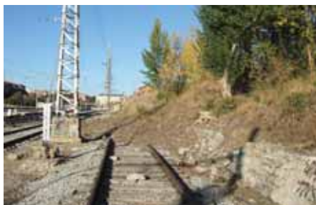
Parada 14. En la ladera lateral de las vías de reserva, se produjo desde mediados del siglo XX un deslizamiento rotacional complejo, que ha tapado algunas de las vías.
